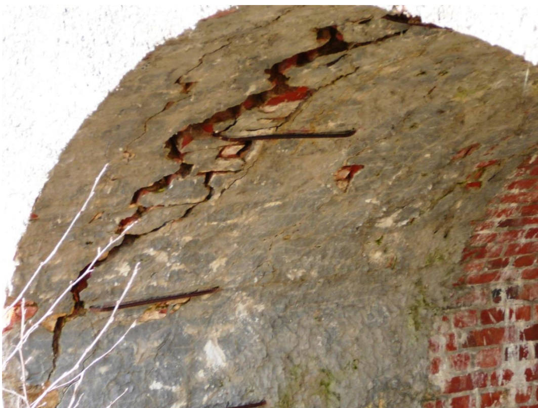
Fot. Nr.14 Przęsło lewobrzeżne – powiększenie pęknięcia przęsła .
