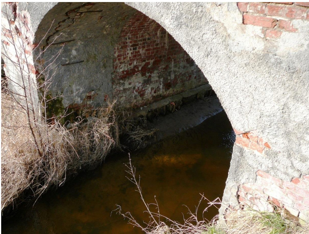
Fot. Nr.13. Przęsło lewobrzeżne – widok od strony WD. Widoczne pęknięcia przęsła.
