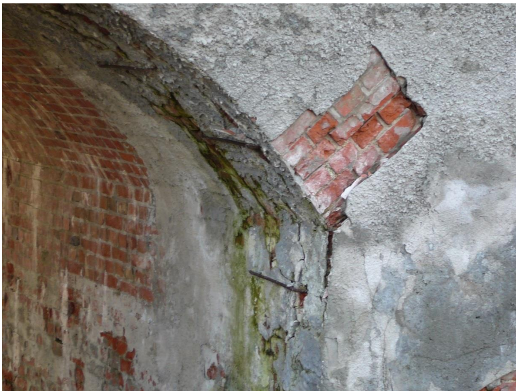
Fot. Nr.15. Przęsło prawobrzeżne – widok od strony WG , pęknięcia w strefie wezłowania.
