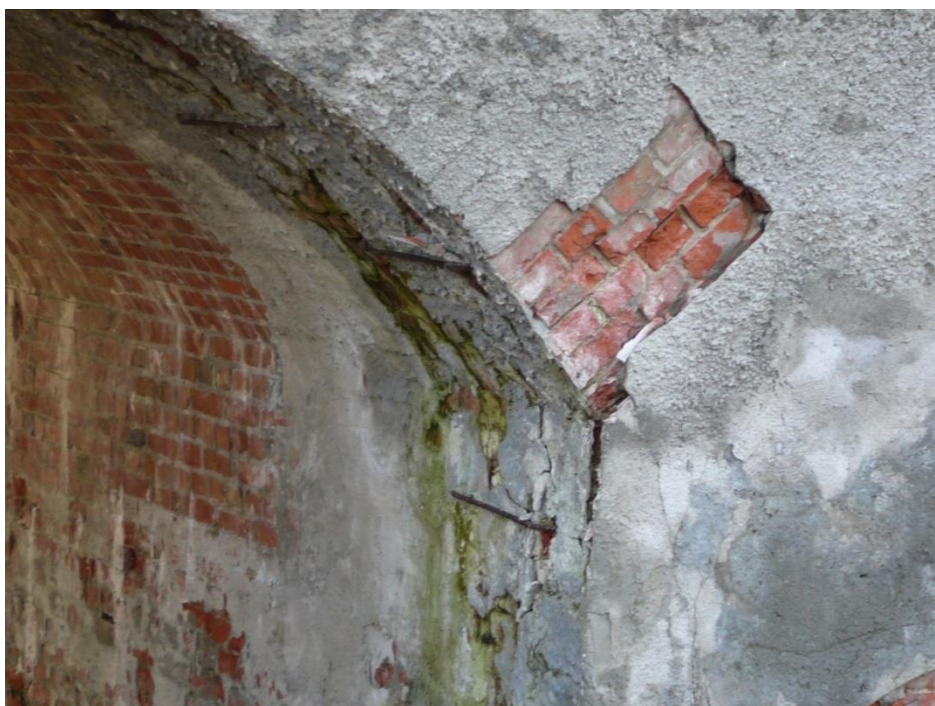
Fot. nr.6. Przęsło prawobrzeżne – widok od strony WG , uszkodzenia i charakter uszkodzeń jak wyżej.
