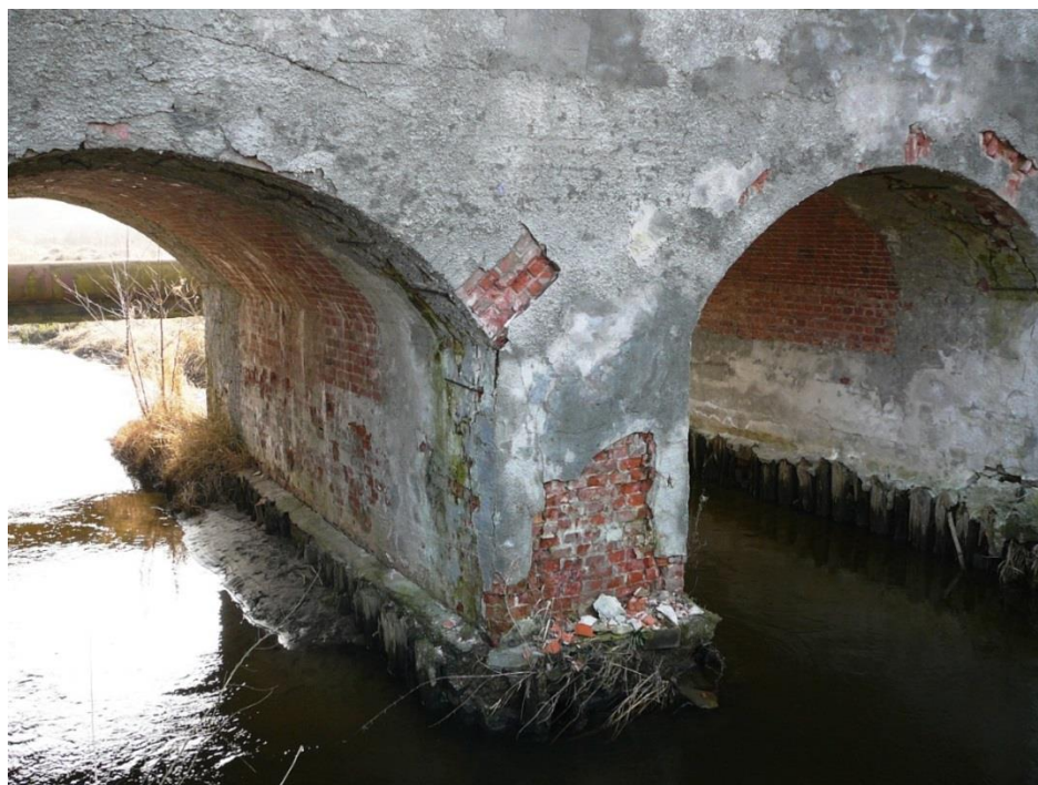
Fot. nr.2. Przyczółek prawobrzeżny i filar mostu od strony WG. Widoczne klamry stalowe założone na kotwach żywicowych na pęknięcia w sklepieniu ceglany.
