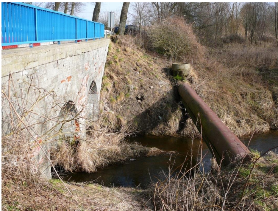
Fot. nr.9. Widok wodociągu w500 mm w rurze osłonowej D=800 mm od strony WD.
