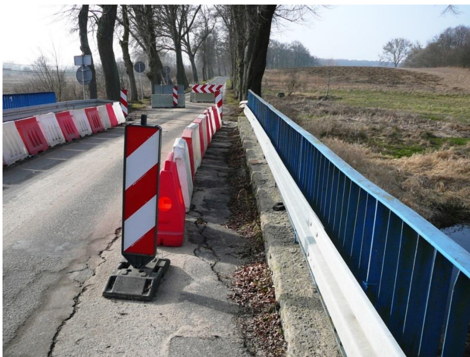
Fot. nr.10. Widok jezdni od strony WG. Zapadnięcie nawierzchni na krawędzi może świadczyć o ubytkach zasypki piaskowej nad kluczem mostu.
