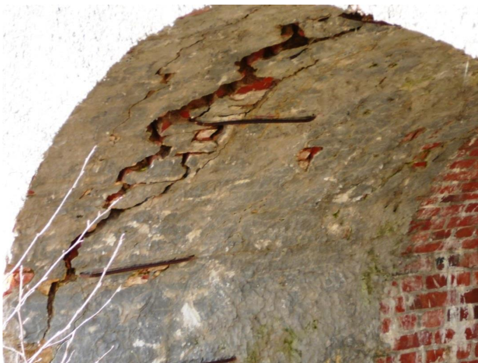
Fot. Nr.5 Przęsło lewobrzeżne - widoczne duże pęknięcie idące od wezłowania do sklepienia. Pęknięcia , które pojawiły się po wykonaniu napraw w 2009r świadczą mogą o niestabilności konstrukcji .
