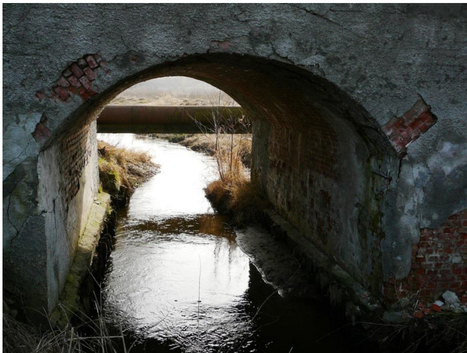
Fot.nr.3. Klucz i wezłowie lewobrzeżnego -widok od WG. Korozja cegieł i ubytki licówki.
