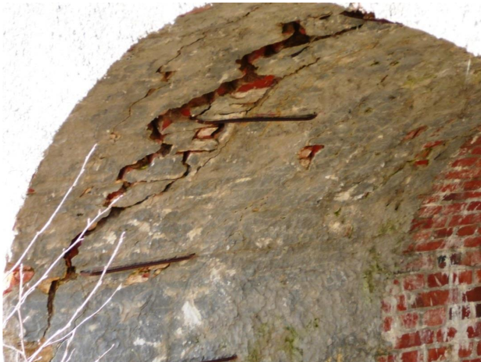
Fot. Nr.3. Przęsło lewobrzeżne - widoczne duże pęknięcie idące od wezłowania do sklepienia. Pęknięcia , które pojawiły się po wykonaniu napraw w 2009r świadczą mogą o niestabilności konstrukcji .
