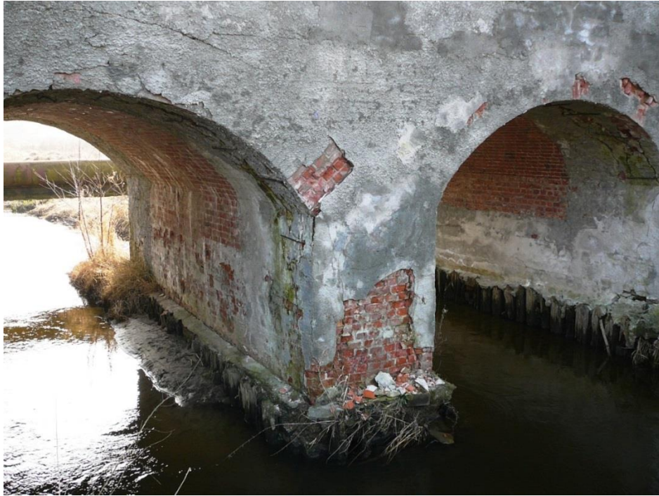
Fot. nr.2. Przyczółek prawobrzeżny i filar mostu od strony WG. Klamry stalowe założone na kotwach żywicznych na pęknięcia w sklepieniu ceglanym.
