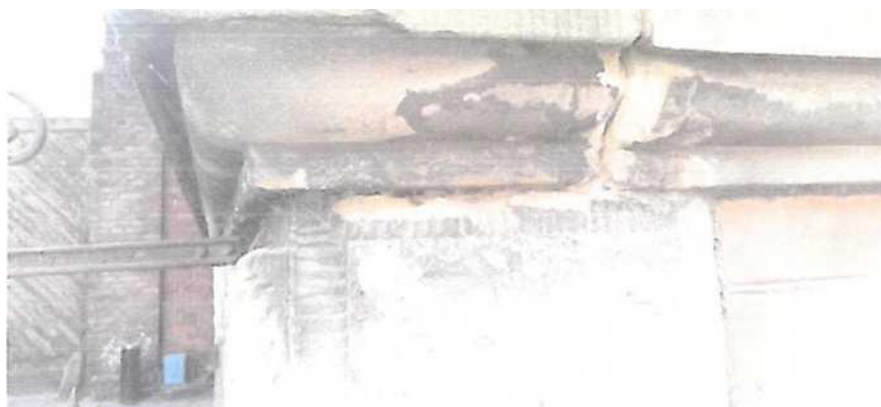
Fot.7. Widok ubytków w blokach z piaskowca.
