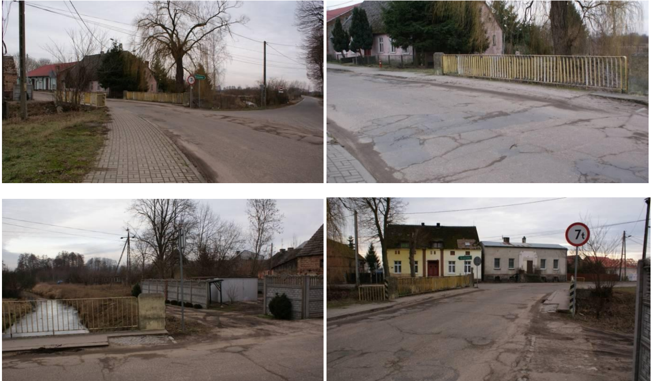
Grafika nr 2 – Stan nawierzchni na moście i na dojazdach
