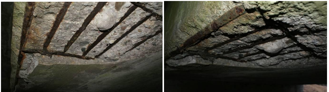
Grafika nr 3 – Stan płyty ustroju nośnego
