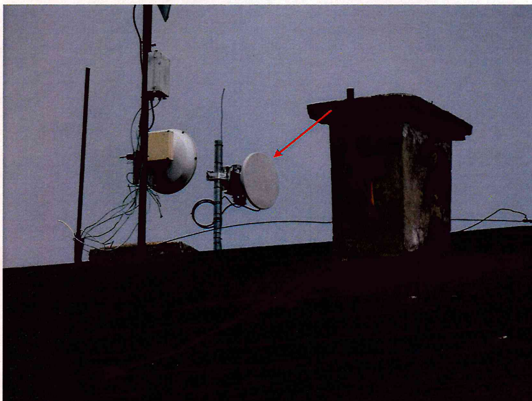
Widok instalacji radiokomunikacyjnej Stacja Netia DOBWB001 - DOBWM00002ANT001 Dobięgniew, ul. Obrońców Pokoju 9.
