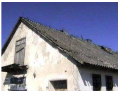
Rysunek 7. Znaczne uszkodzenia powierzchni azbestowych płyt falistych na dachu budynku :
