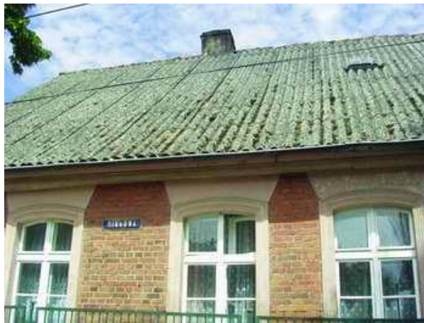
Rysunek 5. Pokrycie dachu eternitem
